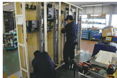
盤内取付配線
